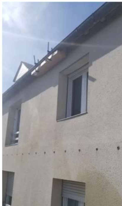
Caisson de protection pour les nids à hauteur trop importante
